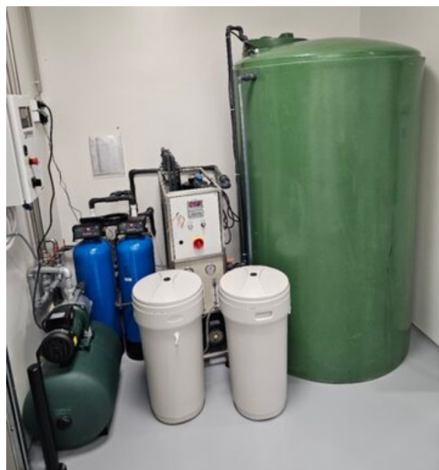
Sistem za filtracijo vode z reverzno osmozo v podjetju Valens d.o.o.
